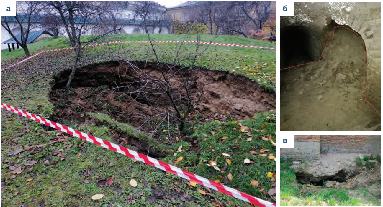
Рис. 2. Наслідки аварії у Митрополичому саду: а – утворення провалів; б – винос ґрунту у підземну споруду № 9 внаслідок суфозійних процесів, контури пульпи показано червоним пунктиром; в – суфозійний винос ґрунту під фундаментами Монастирських мурів, фото І.А. Черевко, 7 листопада 2022 р.
