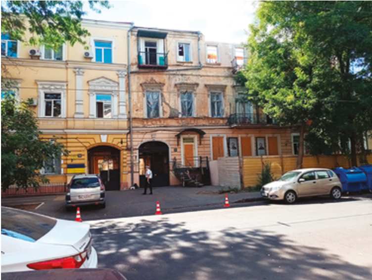
Будинок за адресою вул. Пастера, 54, кв. 3 (балкон і три вікна ліворуч затягнуті плівкою на 2-му поверсі), де пройшло дитинство Валентини Янко, було частково зруйновано 14 листопада 2024 р. російським «шахедом» (1.09.2025)
