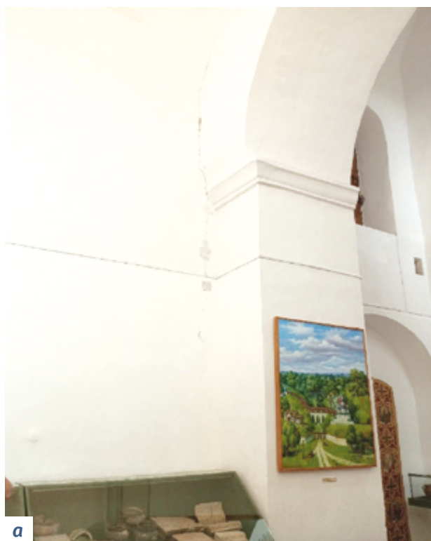
Рис. 8. Тріщини на внутрішніх стінах Іллінської церкви із прибудовою XVIII ст. у місцях деформаційних швів: північна сторона (а), південна сторона (б). Фото Т.В. Кріль, липень 2025 р.
