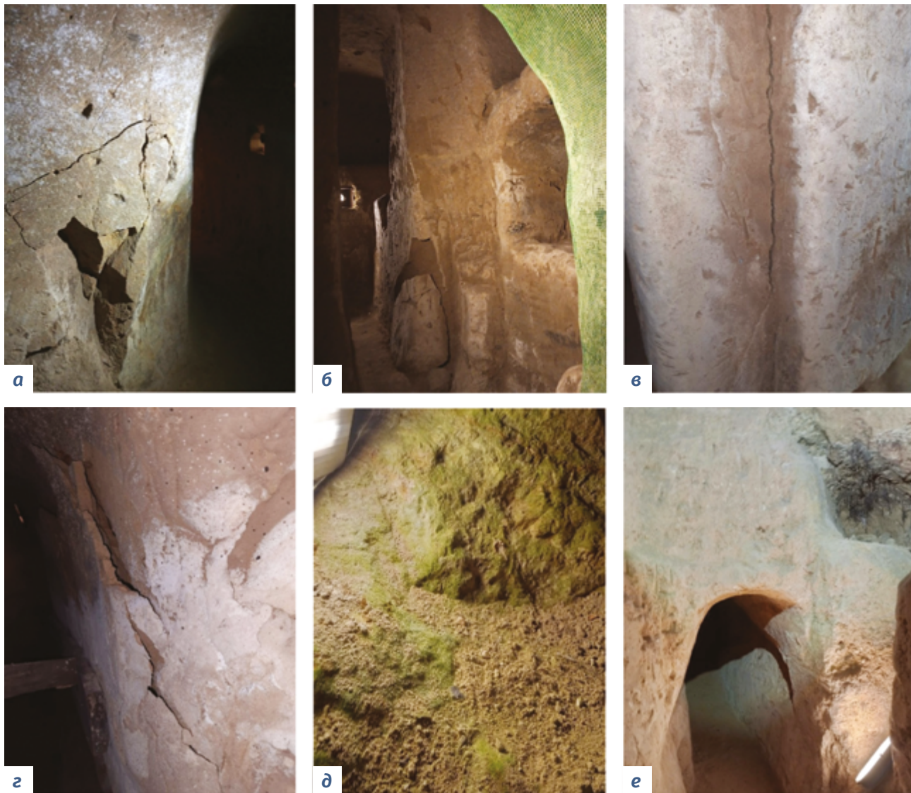
Рис. 4. Вивали ґрунту на спостережній точці 14 (а), між точками 11 та 12 (б); тріщини заколу (відколу) у масиві ґрунту галерей (в, г); біоураження на стінах (д); проростання коріння рослин на склепінні (е). Фото Т.В. Кріль та І.А. Черевко, липень 2025
