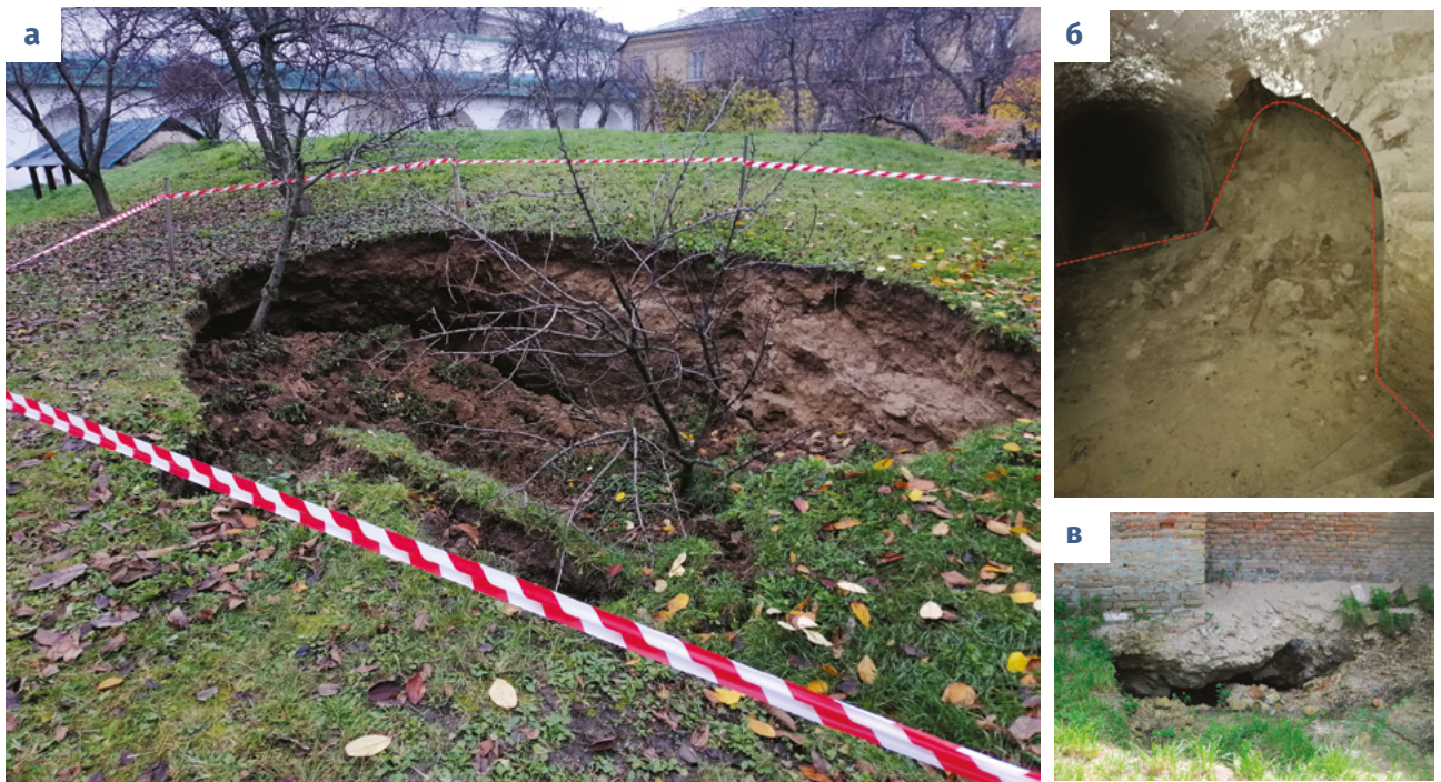
Рис. 2. Наслідки аварії у Митрополичому саду: а – утворення провалів; б – винос ґрунту у підземну споруду № 9 внаслідок суфозійних процесів, контури пульпи показано червоним пунктиром; в – суфозійний винос ґрунту під фундаментами Монастирських мурів, фото І.А. Черевко, 7 листопада 2022 р.
